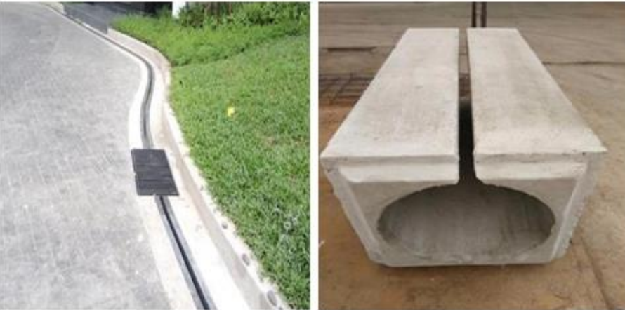
รางระบายน้ำและท่อระบายน้ำแบบใต้ผิวดิน
