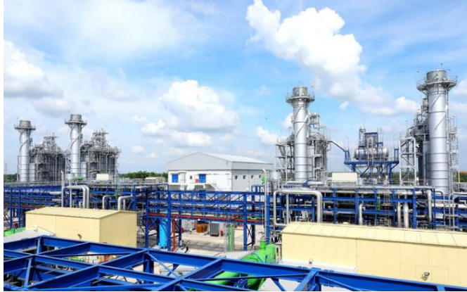
ภาพที่ 3.3 โรงงานผลิตพลังงานไฟฟ้า
