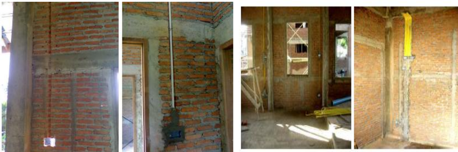
รูปที่ 1 การเดินสายไฟฟ้าในอาคารแบบเปิด(เดินลอย)
