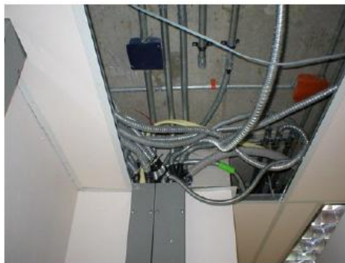
ท่อเหล็กอ่อนร้อยสายไฟ
