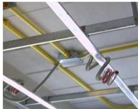
ท่อร้อยสายไฟพีวีซีสีเหลือง
