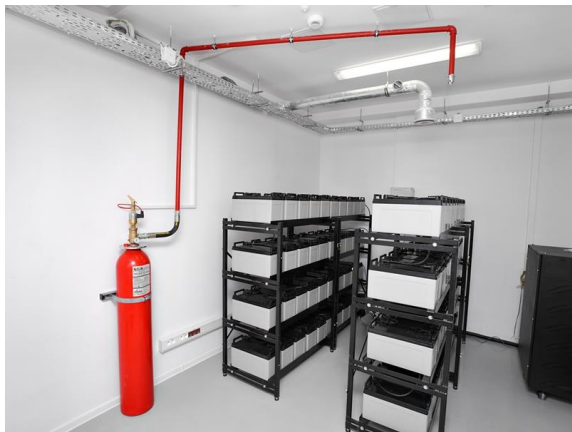
ระบบดับเพลิง
